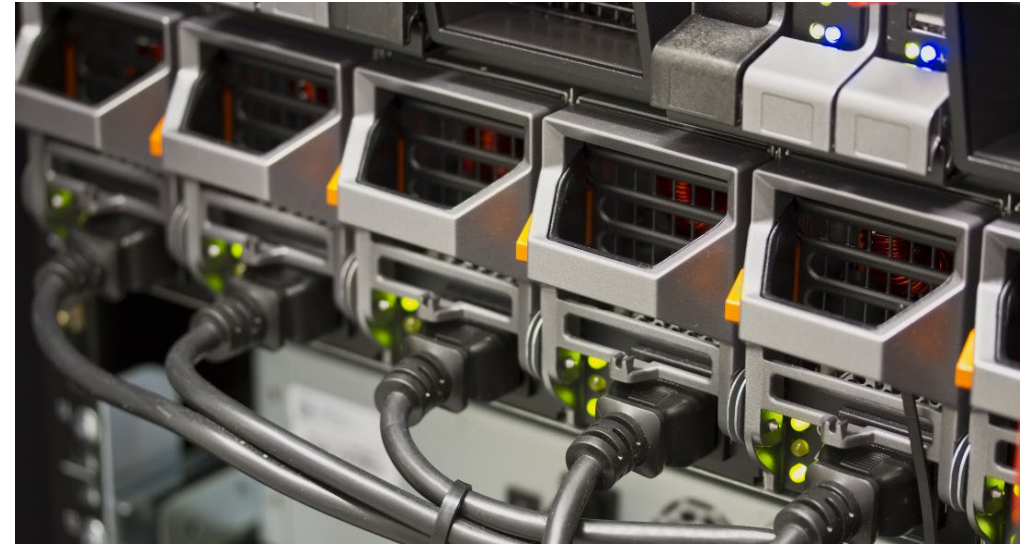
電源（スイッチング電源）
