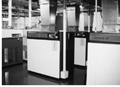
図4 エアコンプレッサシステムの外観
