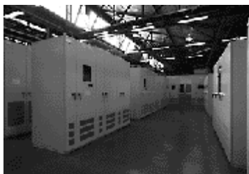
並列冗長UPSシステム外観
