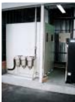
窒素ガス発生装置 Nitrogen gas generators
