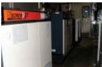
富士山工場 F1棟コンプレッサ Compressor at Fujiyama Works F1 building
