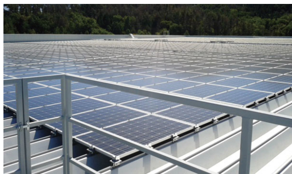
富士山工場の太陽光パネル
