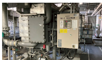
冷温水発生機
