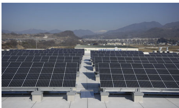
神川工場の太陽光パネル
