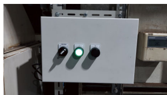
タイマー付き制御盤
