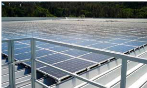
富士山工場の太陽光パネル
