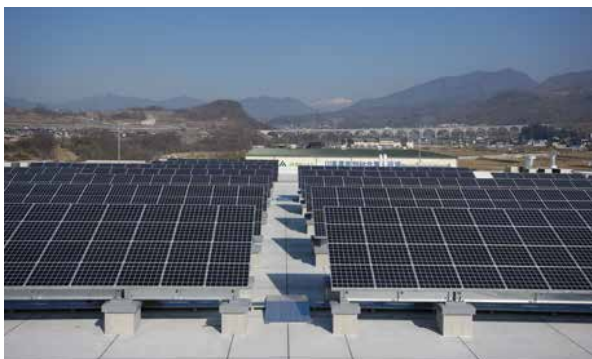
神川工場の太陽光パネル
