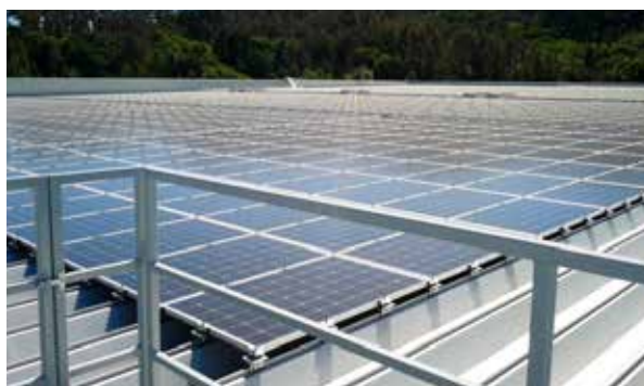
富士山工場の太陽光パネル
