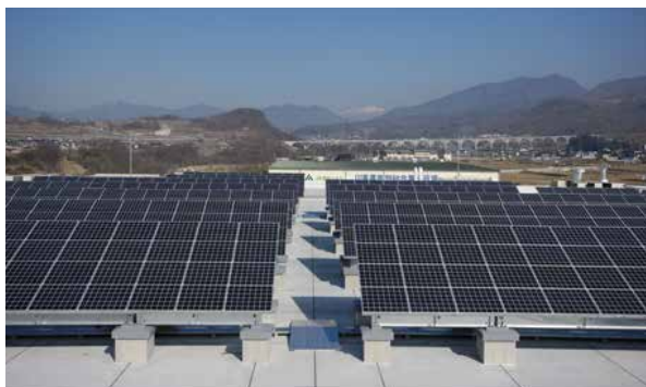
神川工場の太陽光パネル
