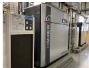
神川工場 コンプレッサー
