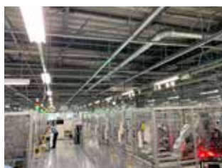
富士山工場 照明設備LED化
