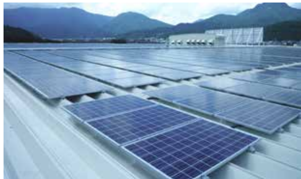
ロジスティックセンターの太陽光パネル
