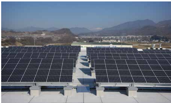
神川工場の太陽光パネル
