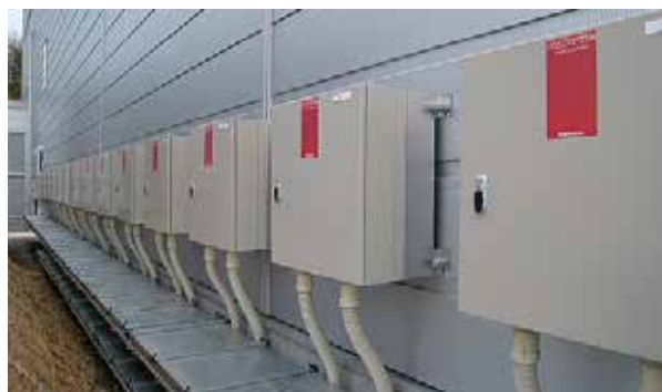
富士山工場の太陽光発電用パワーコンディショナ
