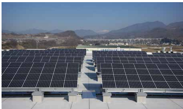
神川工場の太陽光パネル
