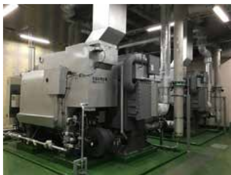
富士山工場 吸収式冷温水機更新機器
